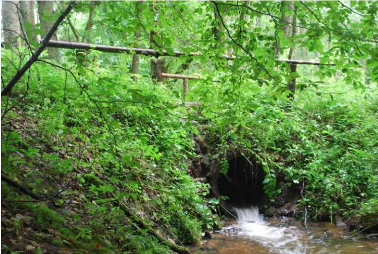
Wegequerung Woogbach nördl. des Waldhauses: Betonrohr ohne Sohsubstrat + Sohlabsturz als Wanderhindernis
