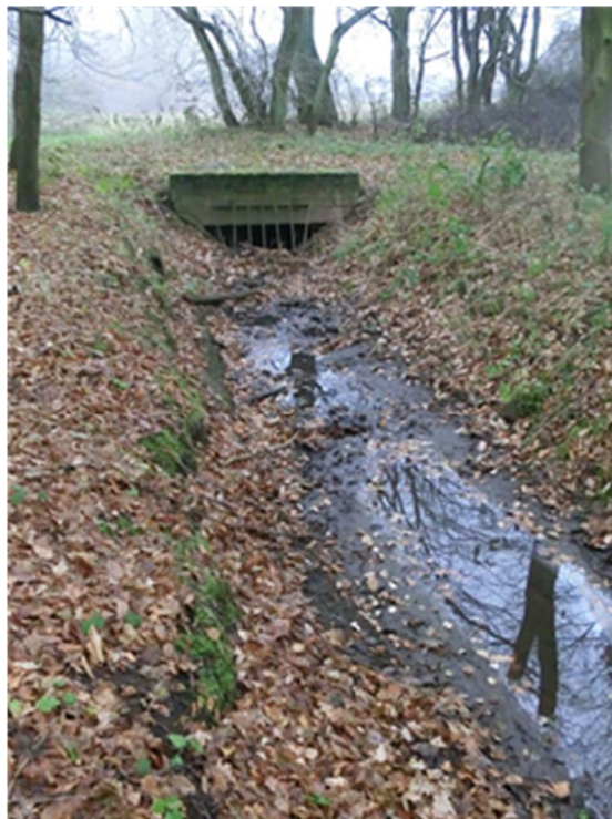
Abb. 8: mit Rechen gesichertes Einlassbauwerk des Schwalbaches vor der Unterquerung des alten Grubenweges
