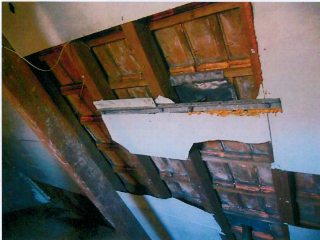
Abb. 2: Gipskartonplatten unter dem Ziegeldach; die Mausohren hängen zwischen Platten und Ziegeln.
